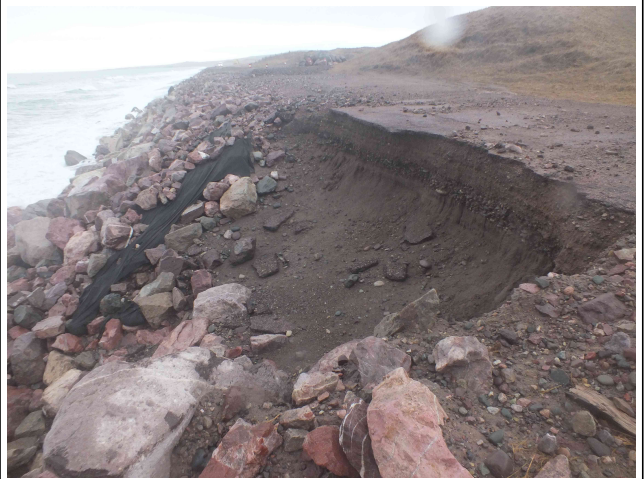
Evolution de l'effondrement entre le central et l'effondrement aval
