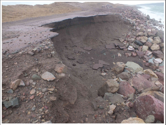
Evolution de l'effondrement entre la digue amont et l'effondrement central
