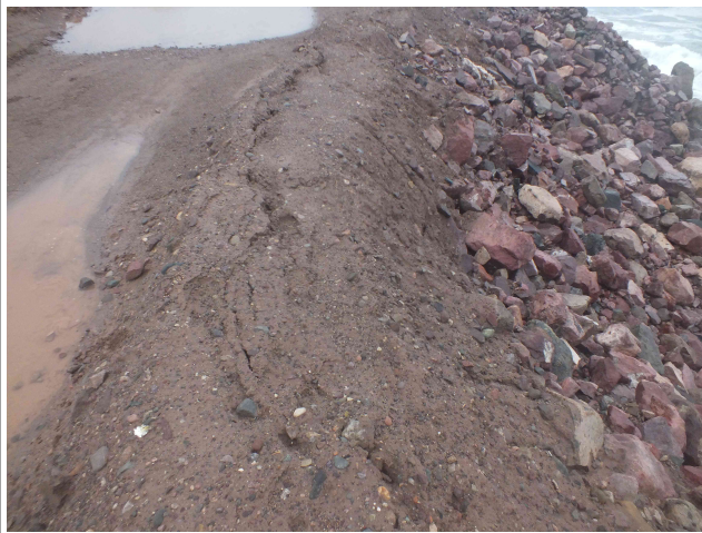
Légère évolution du tassement du petit merlon devant l'effondrement central
