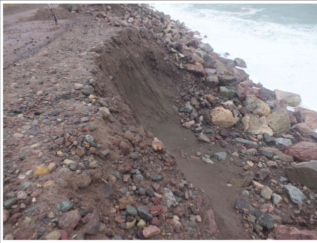
Evolution sur l'effondrement sur la digue amont
