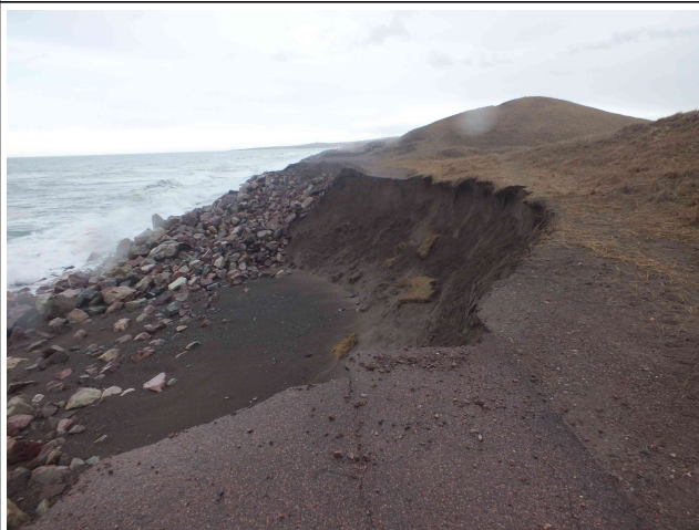
Evolution de l'effondrement aval
