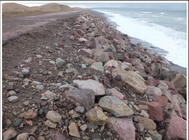
Evolution du glissement aval
